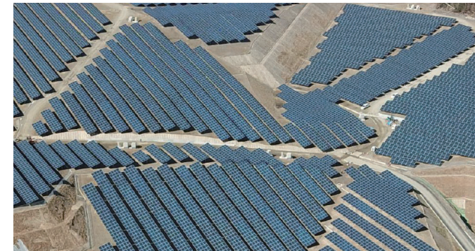
角田市太陽光発電所
