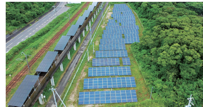
都農太陽光発電所
