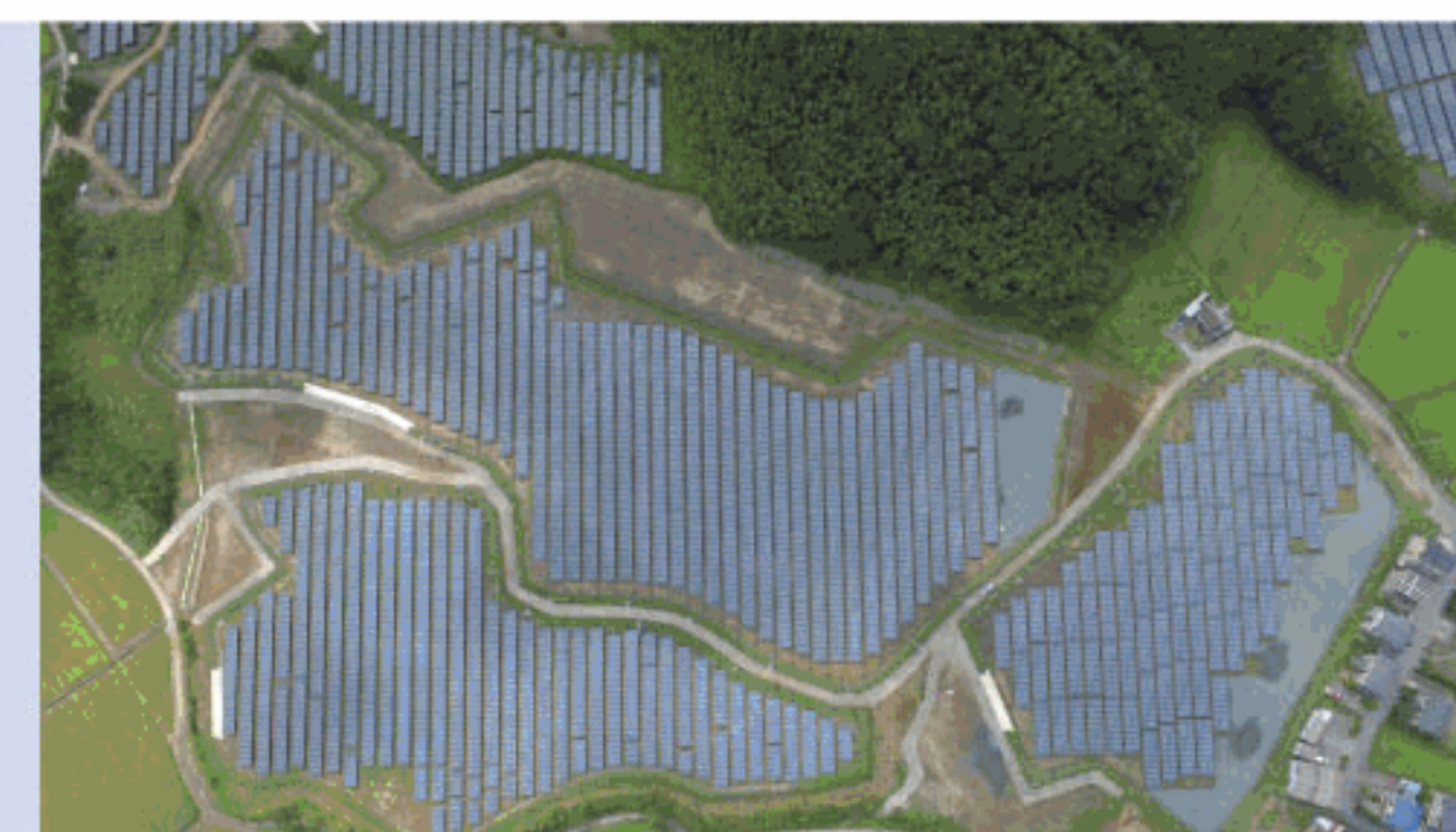
千葉県香取発電所
