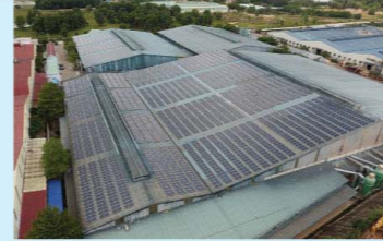
EGE Tien Dat Factory 1MW
